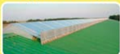
Световые и вентиляционные коньки
